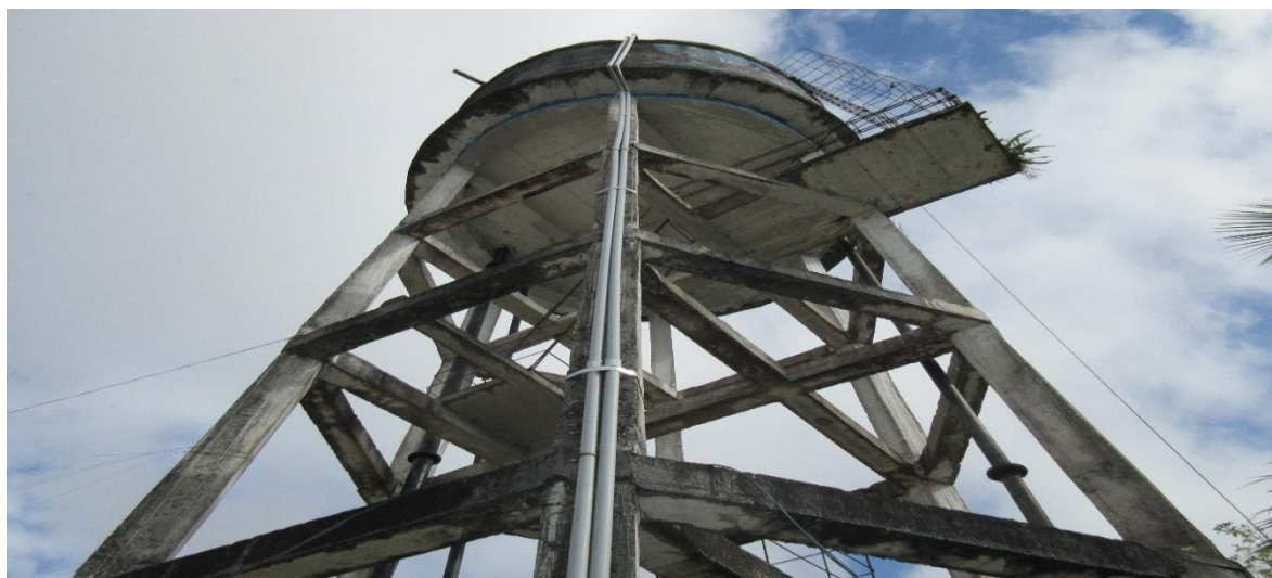
TANQUE DE AGUA PROVENIENTE DE ACUIFERO; YANTALO JULIO 2017
