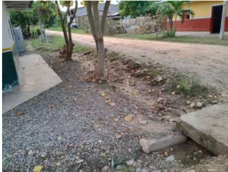
Situación actual del C.P. sin obras de drenaje
