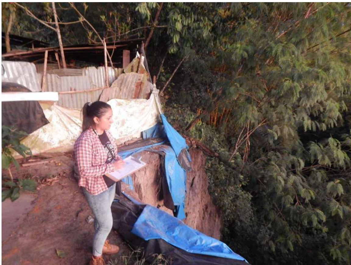
Figura 50 Vivienda colapsada en la parte norte del barranco.
