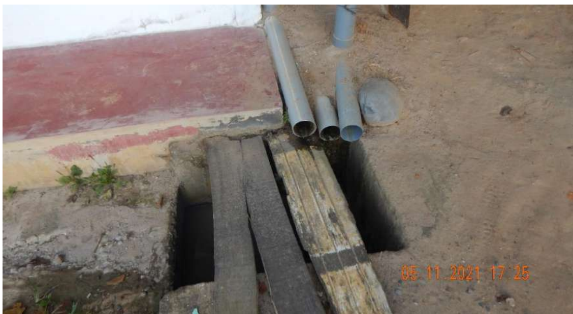
Figura 11 Colectores pluviales que son dirigidos hacia el barranco.
