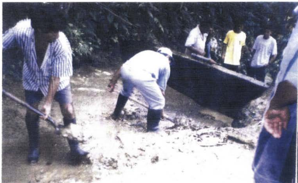
Foto N° 05: Se observa a los socios de la junta de usuarios del agua para consumo, en la faena de limpieza de la captación 01, problema que se presenta después de las lluvias por exceso de sedimentos arrastrados en el agua.
