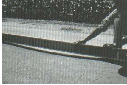
Figura 29. Depresión con nivel de severidad alta.
