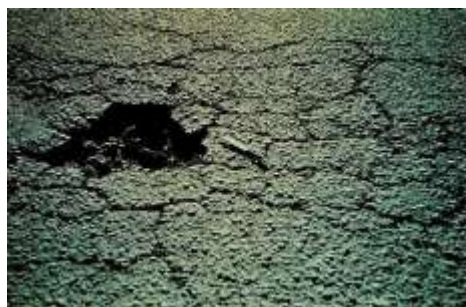
Figura 14. Piel de cocodrilo con nivel de severidad alto.
