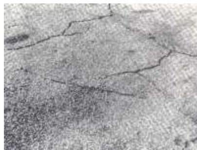
Figura 18. Agrietamiento en bloque con nivel de severidad leve o bajo.
