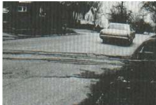
Figura 51. Cruce de vía férrea con nivel de severidad alta.
