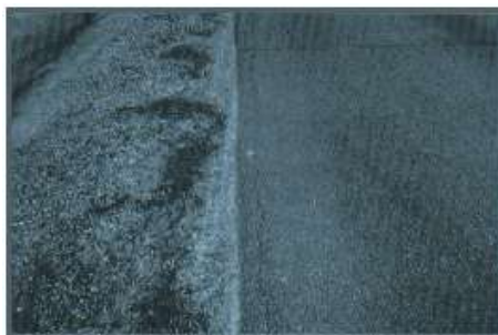
Figura 30. Grieta de borde con nivel de severidad bajo o leve.
