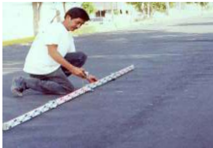
Figura 25. Corrugación con nivel de severidad media.
