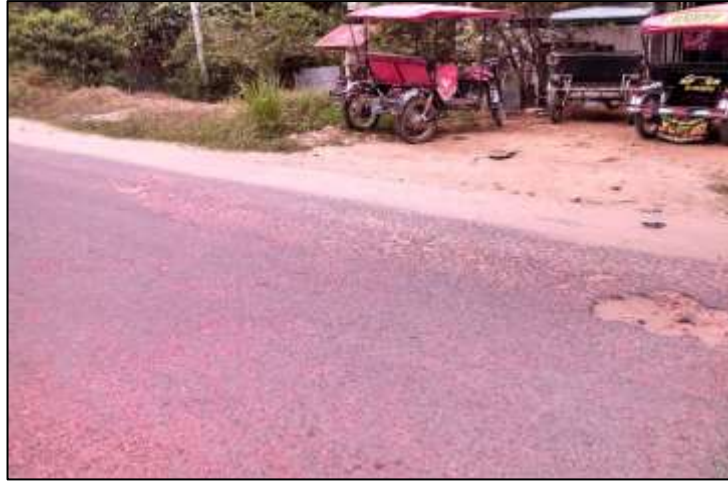
Figura 94. Cuadra 10 – Baches (Huecos) y Grietas longitudinales y transversales.
