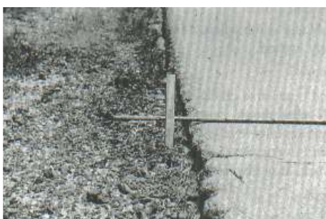
Figura 38. Desnivel carril/berma con nivel de severidad alta.
