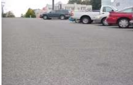
Figura 24. Corrugación con nivel de severidad bajo o leve.
