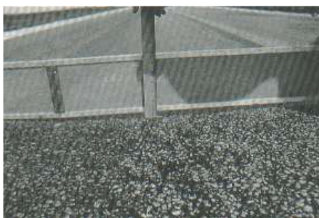
Figura 53. Ahuellamiento con nivel de severidad media.
