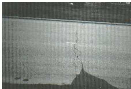
Figura 40. Grietas longitudinales y transversales con nivel de severidad media.
