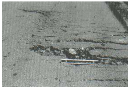
Figura 60. Grietas parabólicas con nivel de severidad alta.
