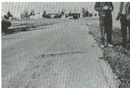
Figura 22. Abultamientos y hundimientos con nivel de severidad media.
