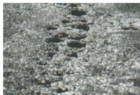
Figura 64. Meteorización y/o desprendimiento de agregados con nivel de severidad alta.
