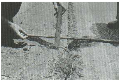
Figura 37. Desnivel carril/berma con nivel de severidad media.
