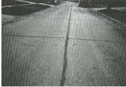
Figura 33. Grieta de reflexión de junta con nivel de severidad bajo o leve.
