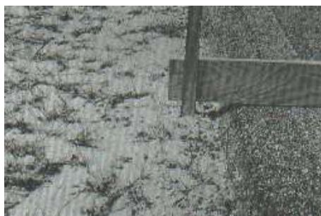
Figura 36. Desnivel carril/berma con nivel de severidad bajo o leve.
