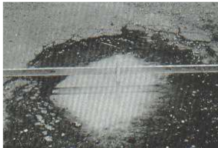
Figura 48. Huecos con nivel de severidad alta.
