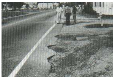
Figura 32. Grieta de borde con nivel de severidad alta.
