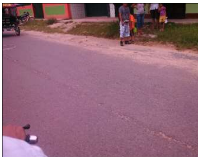
Figura 92. Cuadra 8 – Grietas longitudinales.
