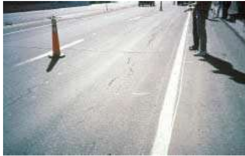
Figura 12. Piel de cocodrilo con nivel de severidad bajo o leve.
