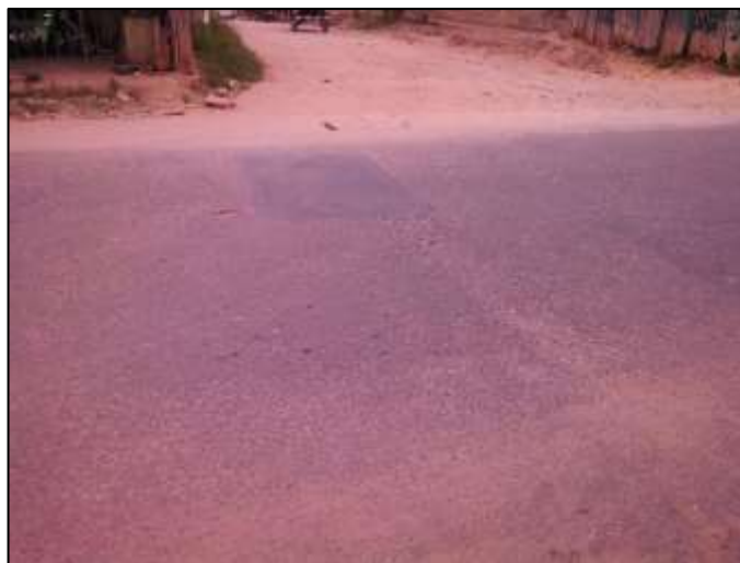
Figura 100. Cuadra 14 – Parcheo y Grietas longitudinales.
