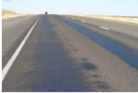
Figura 16. Exudación con nivel de severidad media.
