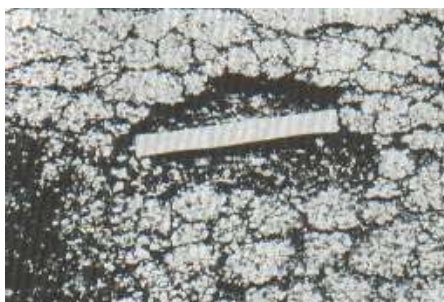
Figura 46. Huecos con nivel de severidad baja o leve.
