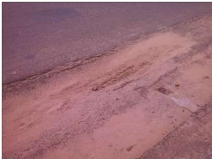
Figura 99. Cuadra 13 – Ahuellamiento y Grieta longitudinal.
