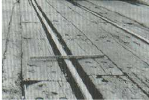
Figura 50. Cruce de vía férrea con nivel de severidad media.
