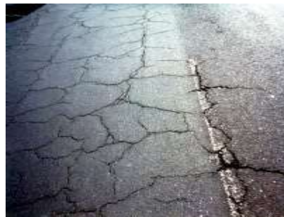
Figura 19. Agrietamiento en bloque con nivel de severidad media.
