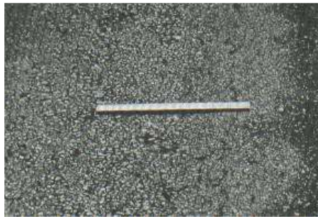
Figura 62. Meteorización y/o desprendimiento de agregados con nivel de severidad bajo o leve.
