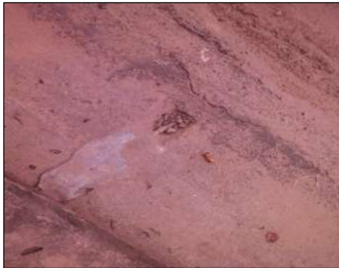
Figura 98. Cuadra 12 – Grieta de borde y Bache (Hueco).
