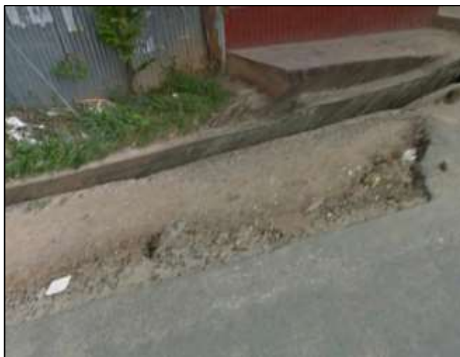
Figura 91. Cuadra 7 – Meteorización y/o desprendimiento de agregados.
