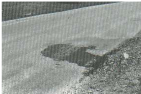
Figura 43. Parcheo y acometidas de servicio con nivel de severidad media.
