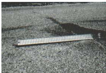
Figura 21. Abultamientos y hundimientos con nivel de severidad bajo o leve.
