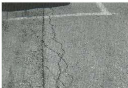
Figura 31. Grieta de borde con nivel de severidad media.
