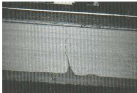
Figura 39. Grietas longitudinales y transversales con nivel de severidad bajo o leve.
