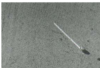
Figura 58. Grietas parabólicas con nivel de severidad bajo o leve.
