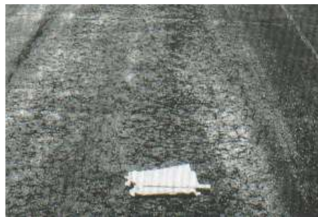
Figura 63. Meteorización y/o desprendimiento de agregados con nivel de severidad media.
