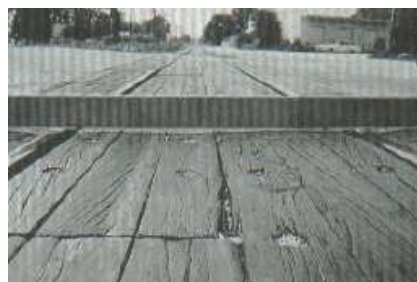
Figura 49. Cruce de vía férrea con nivel de severidad bajo o leve.
