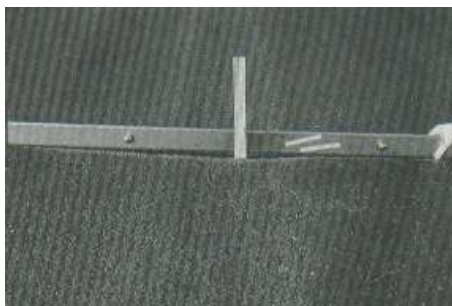
Figura 52. Ahuellamiento con nivel de severidad bajo o leve.
