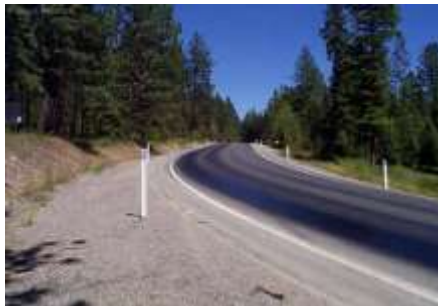
Figura 17. Exudación con nivel de severidad alta.
