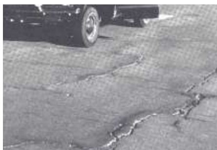
Figura 20. Agrietamiento en bloque con nivel de severidad alta.
