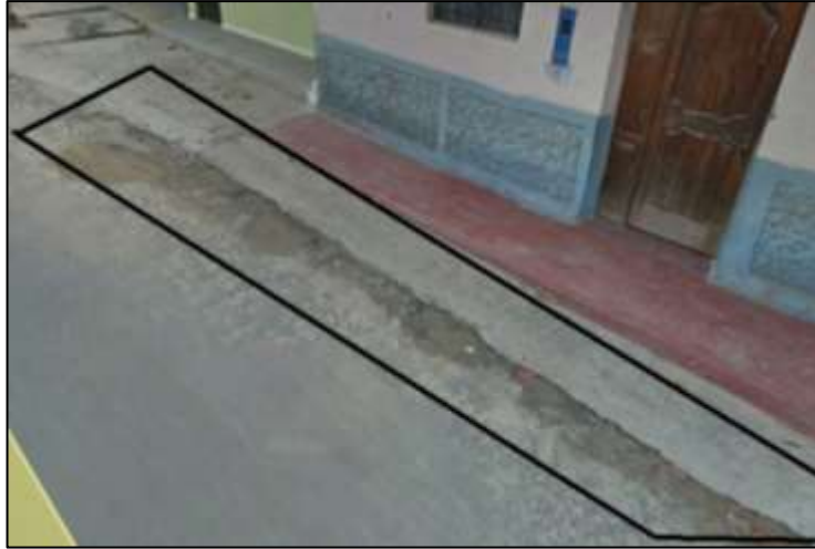
Figura 85. Cuadra 2 – Desprendimiento de agregados.
