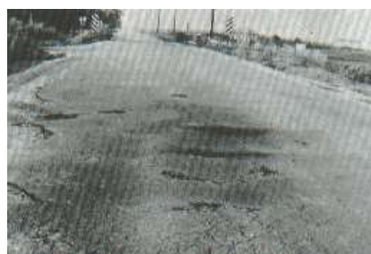
Figura 56. Desplazamiento con nivel de severidad media.
