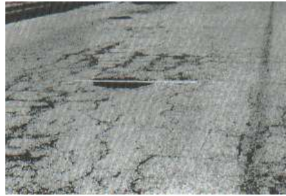
Figura 47. Huecos con nivel de severidad media.
