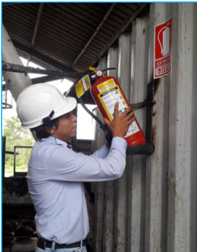
Fotografía 4. Colocando el extintor en un área accesible de la empresa.
