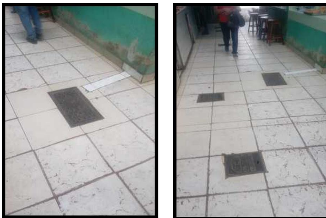
Figura 22. Tapas de los desagües
