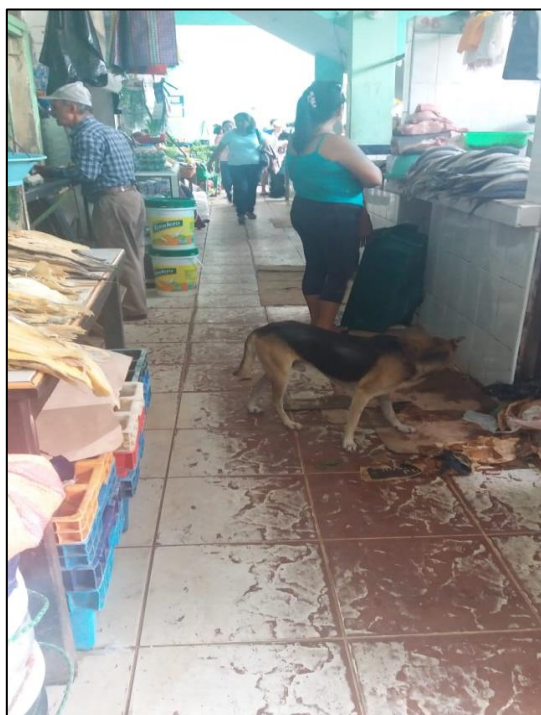
Figura 5. Condición de los pisos
