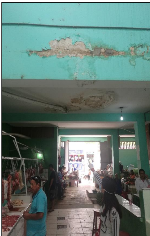
Figura 4. Condiciones del techo
