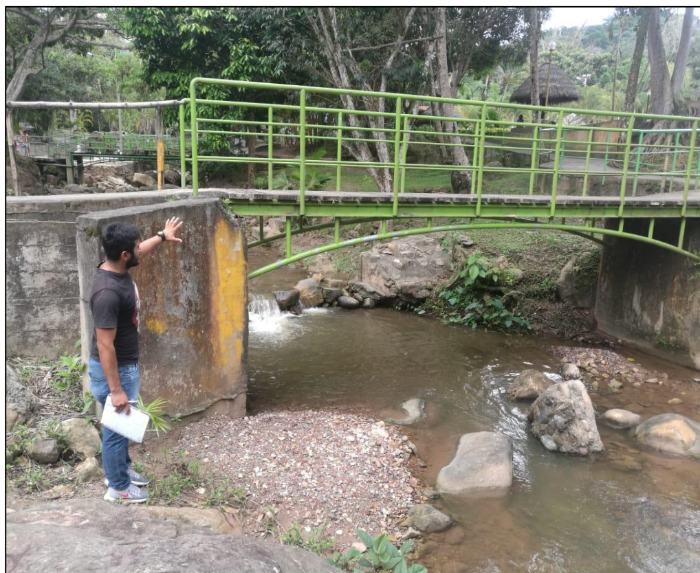
Fotografía 1: Estado de los puentes peatonales
