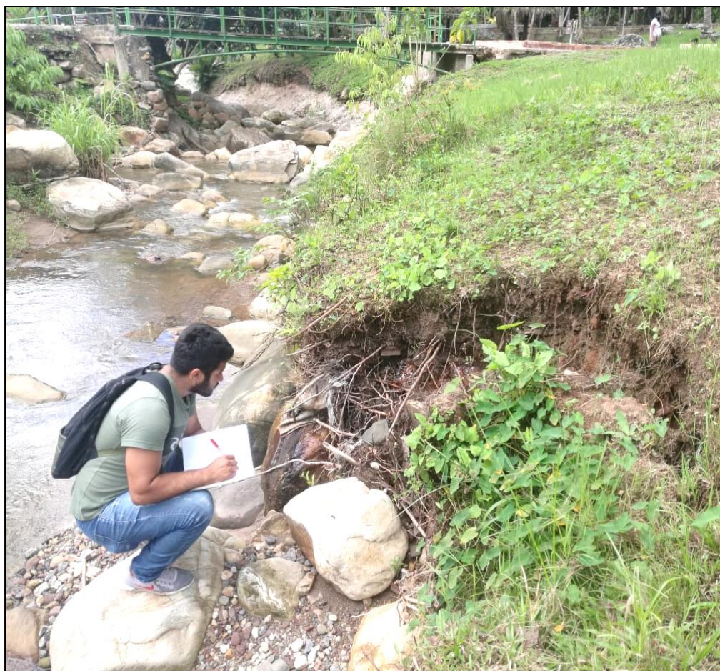
Fotografía 2. Erosión del suelo cercano a la quebrada
