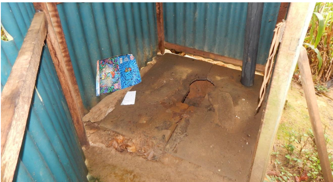
Fotografía 9. Letrina de hoyo seco de condición colapsado.
