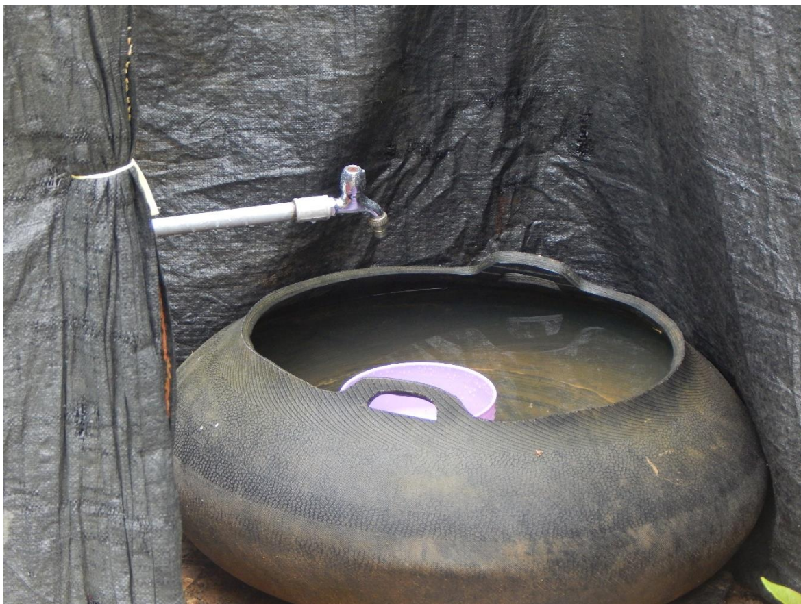
Fotografía 13. Conexión domiciliaria y depósitos de almacén de agua.
