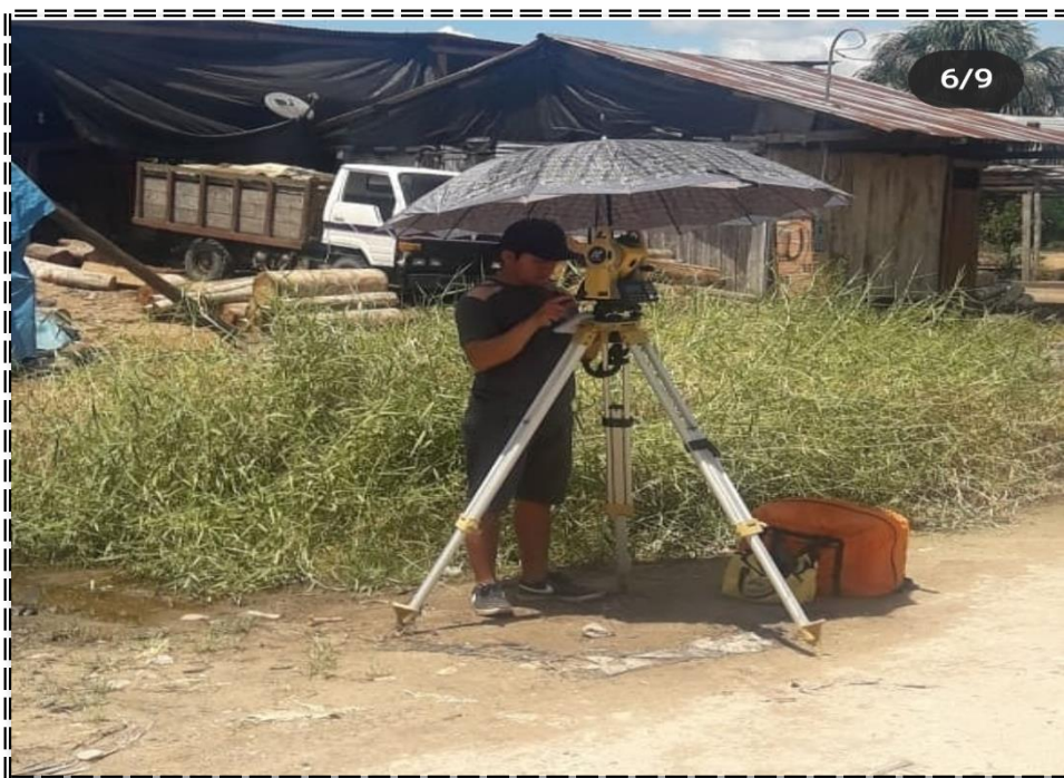
Fotografía 8: Recopilación de datos en campo mediante levantamiento topográfico. Estudio básico para el diseño del abastecimiento de agua potable en la Localidad.
