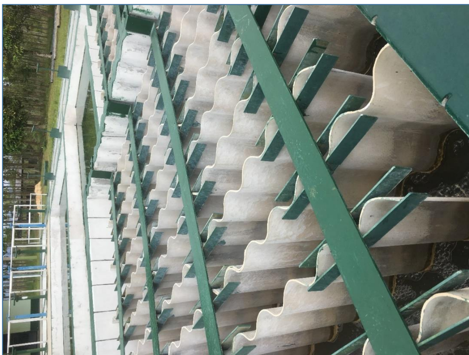
Fotografía 2. Floculador: láminas de fibrocemento
