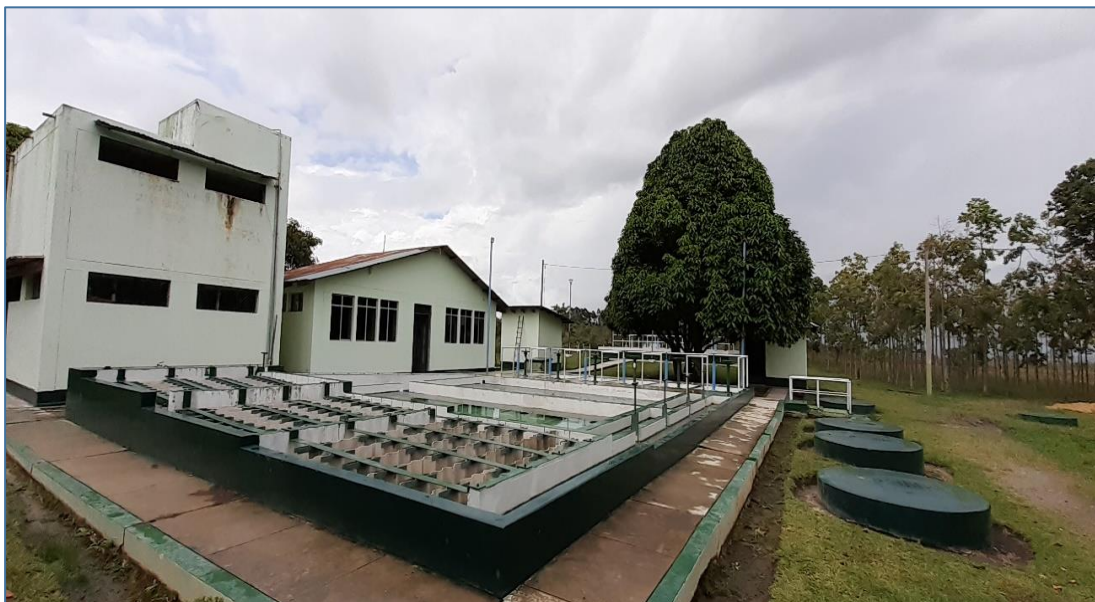
Fotografía 7. Planta de Tratamiento de Agua Potable del Distrito de Soritor.
