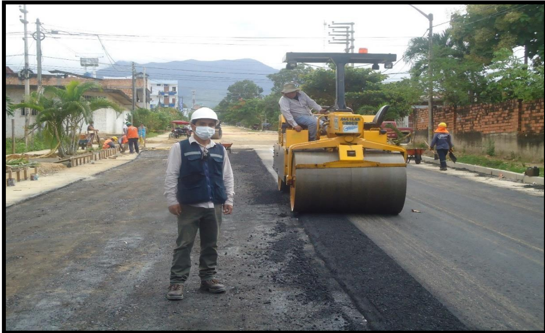
Figura 31: En la figura se muestra la compactación de la carpeta asfáltica con rodillo compactador de asfalto.
