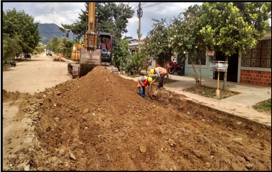
Figura 11: En la figura se observa la partida del corte masivo con maquinaria en material común.
