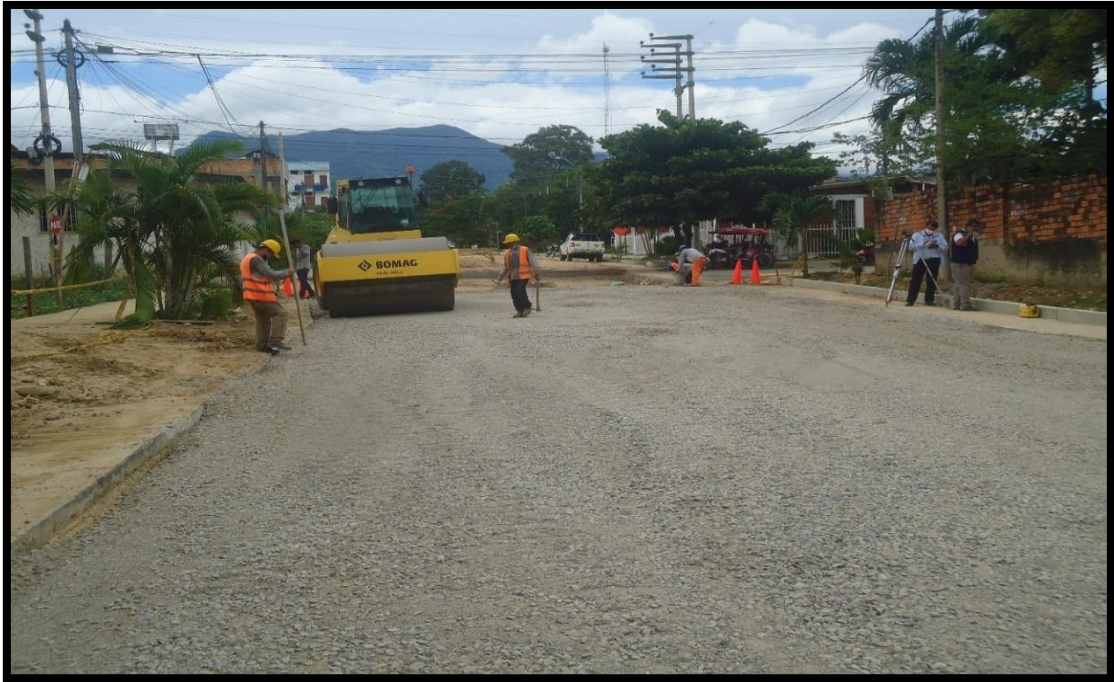
Figura 25: En la figura se muestra la compactación de material granular con rodillo vibratorio de la partida “Base granular”
