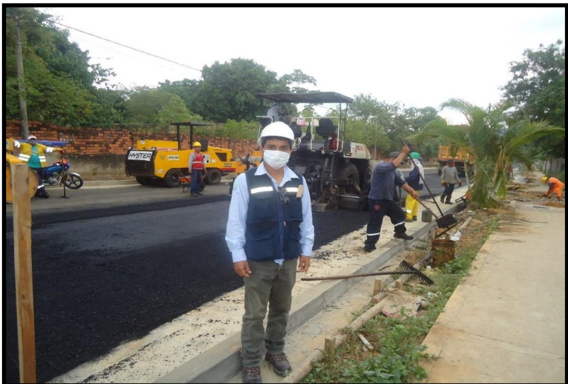
Figura 30: En la imagen se observa la colocación de la carpeta asfáltica con una máquina extendedora de asfalto, apoyada por el personal de obra.
