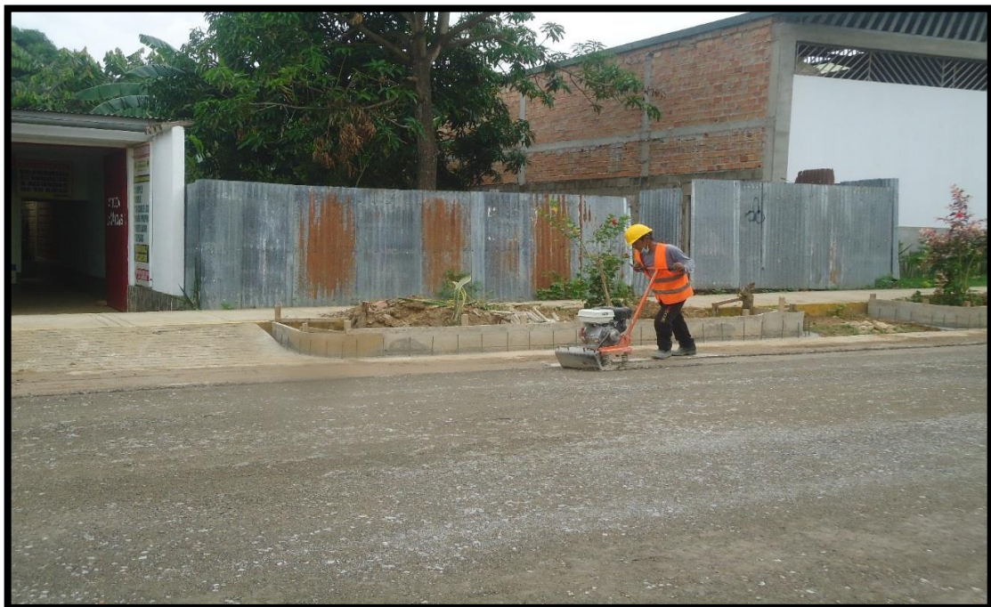
Figura 26: En la figura se observa la compactación de bordes, con plancha compactadora manual; de la partida “Base granular”
