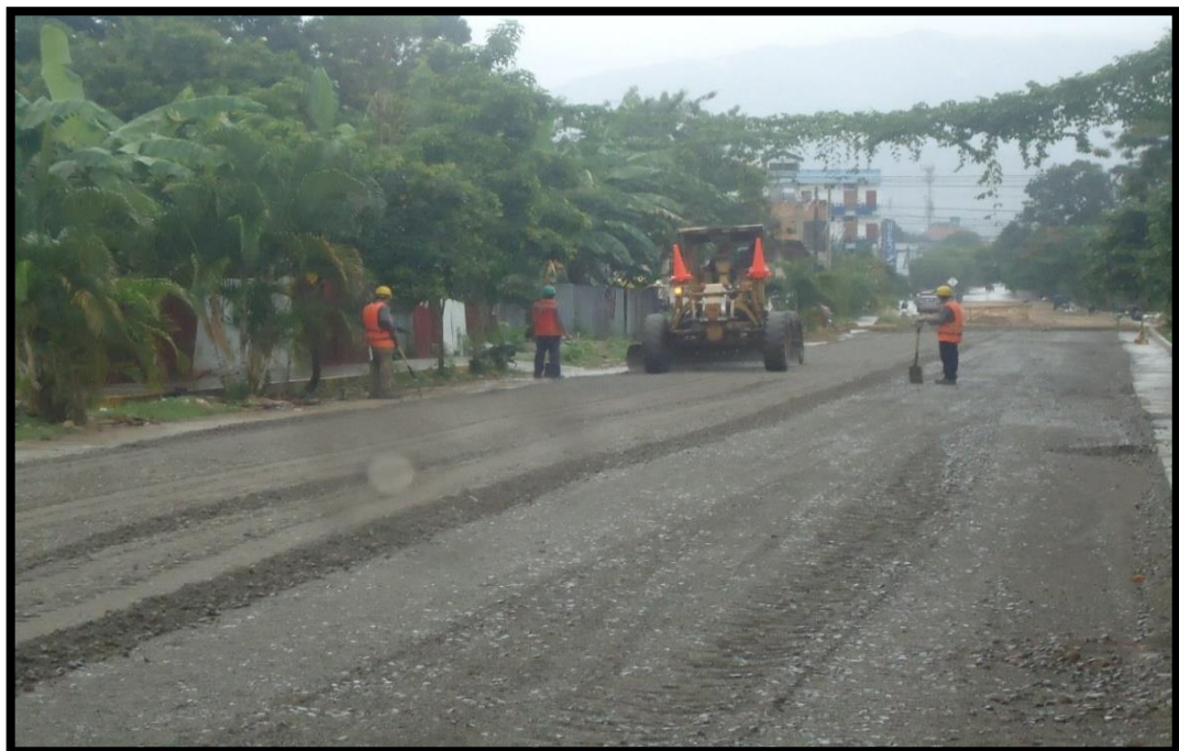
Figura 24: En la figura se muestra el esparcido de material granular con motoniveladora de la partida “Base granular”
