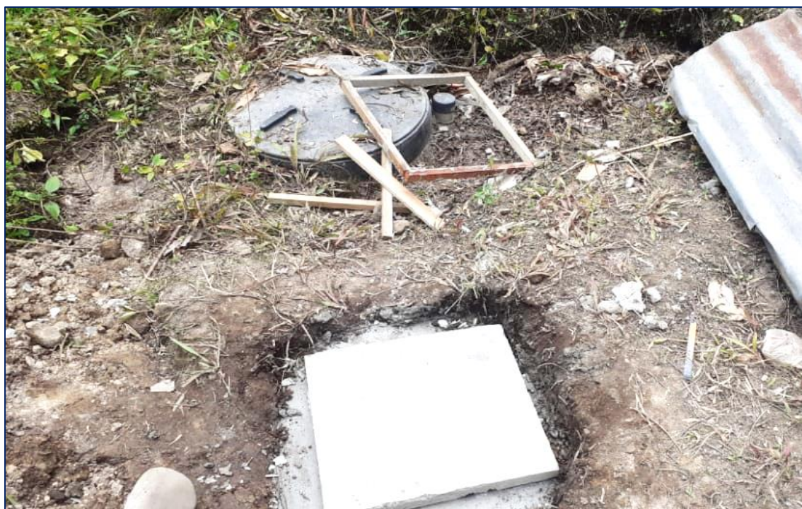
Fotografía 2: Caja de registro de salida de biodigestor, para recolección de muestras de agua tratada.
