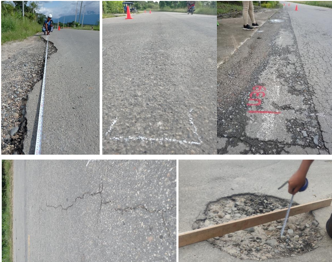
Figura 9. Foto de grieta de borde, desprendimiento de agregados, parche, grieta transversal y hueco (Bache).
