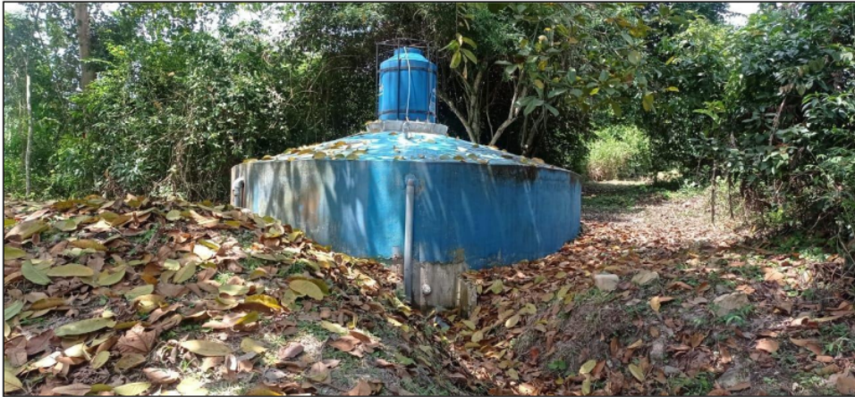
Fotografía 04: Tanque de reserva N° 2 que abastece a la población actual.
