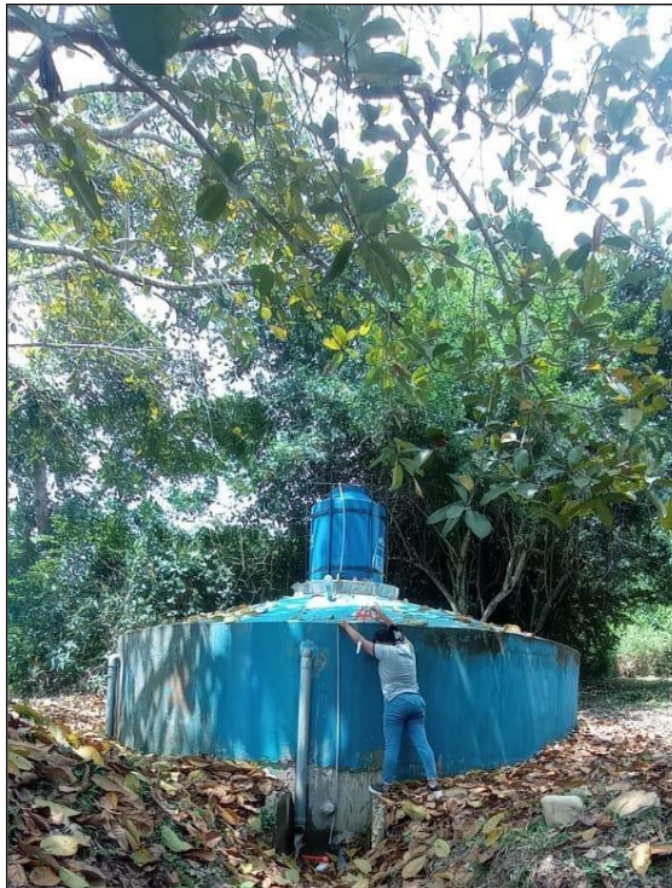
Fotografía 05: Medición del Tanque de reserva N° 2.
