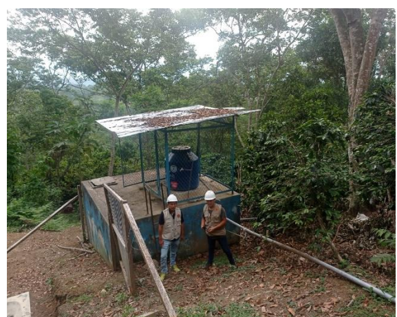
Fotografía N° 08: Reservorio circular actual de la red de abastecimiento.
