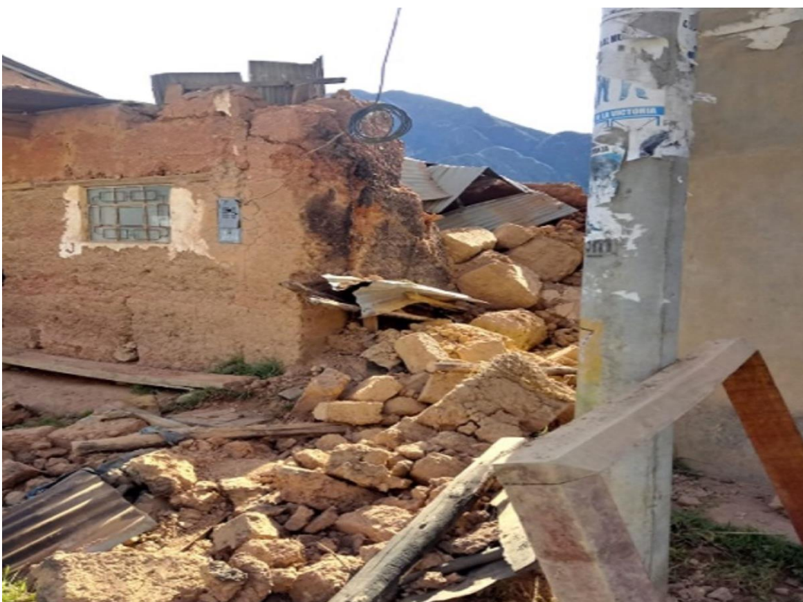
Figura 7. Estado de edificaciones de adobe afectados por sismo
