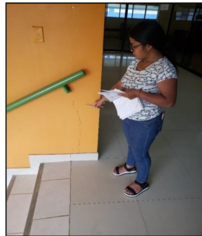
Foto N° 08: Toma de datos Insitu para realizar la evaluación por el método de Hirosawa del segundo nivel del Pabellón Administrativo 02 de la Facultad de Ingeniería Agroindustrial (Fuente: Elaboración propia)
