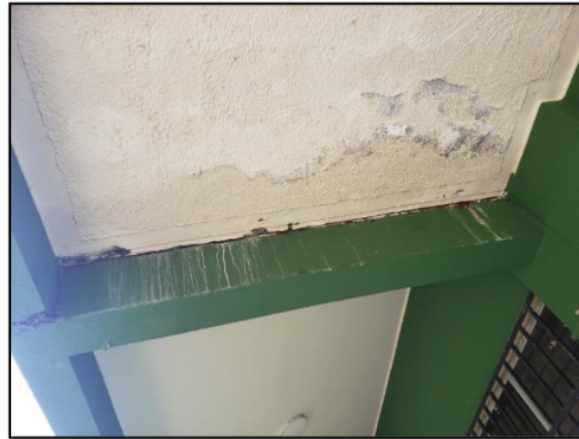
Foto N° 10: Presencia de humedad en la losa del segundo nivel del Pabellón de Aulas de la Facultad de Ciencias Agrarias (Fuente: Elaboración propia)
