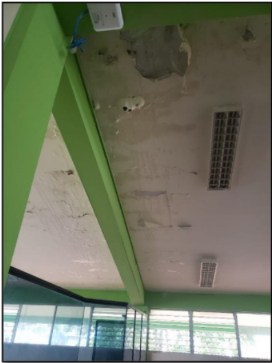
Foto N° 09: Presencia de humedad en la losa del segundo nivel del Pabellón Administrativo 02 de la Facultad de Ingeniería Agroindustrial (Fuente: Elaboración propia)
