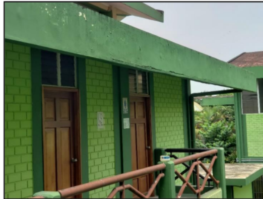
Foto N° 15: Desprendimiento del concreto en vigas del segundo nivel del Pabellón de SS-HH de la Facultad de Ciencias Agrarias (Fuente: Elaboración propia)
