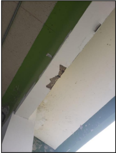
Foto N° 16: Desprendimiento del concreto y la exposición de acero de refuerzo en vigas del segundo nivel del Pabellón de Laboratorios y Gabinetes de la Facultad de Ingeniería Agroindustrial (Fuente: Elaboración propia)
