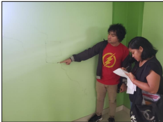
Foto N° 11: Presencia de paredes fisuradas segundo nivel del Pabellón Administrativo 01 de la Facultad de Ciencias Agrarias (Fuente: Elaboración propia)
