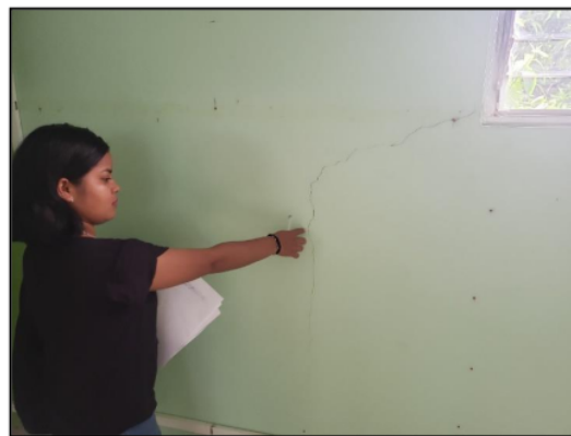
Foto N° 12: Presencia de paredes fisuradas por falta de confinamiento y aislamiento entre las paredes colindantes y las ventanas del segundo nivel del Pabellón Administrativo 01 de la Facultad de Ciencias Agrarias (Fuente: Elaboración propia)
