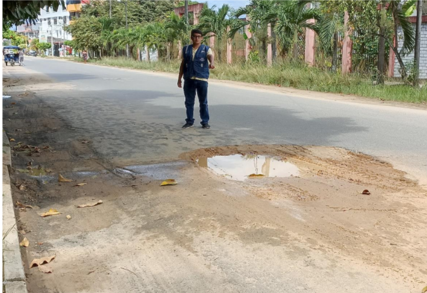
Fotografía 3: Se observa al tesista indicando el deterioro/falla de bache, de gravedad 3 en el Jr. Comandante Chirinos Cuadra - 4.
