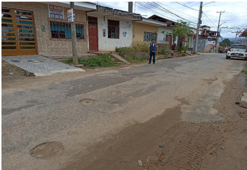
Fotografía 1: Se visualiza al tesista en el Jr. Alfonso Ugarte Cuadra – 1 identificando el conjunto de deterioros/fallas de baches y reparaciones.
