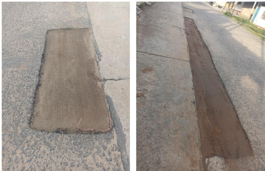
Figura 8: Reparación de baches en el Jr. Lorenzo Morales Cuadra 02 de la Urb. Fonavi. El color que se muestra se debe a que después del compactado ha caído una lluvia y el agua ha discurrido sobre estos ya que no ha sido colocada la carpeta asfáltica.
