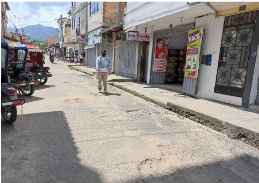
Fotografía 14: Se visualiza al testista un conjunto de deterioros/fallas de baches y reparaciones en el Jr. José Olaya Cuadra – 1
