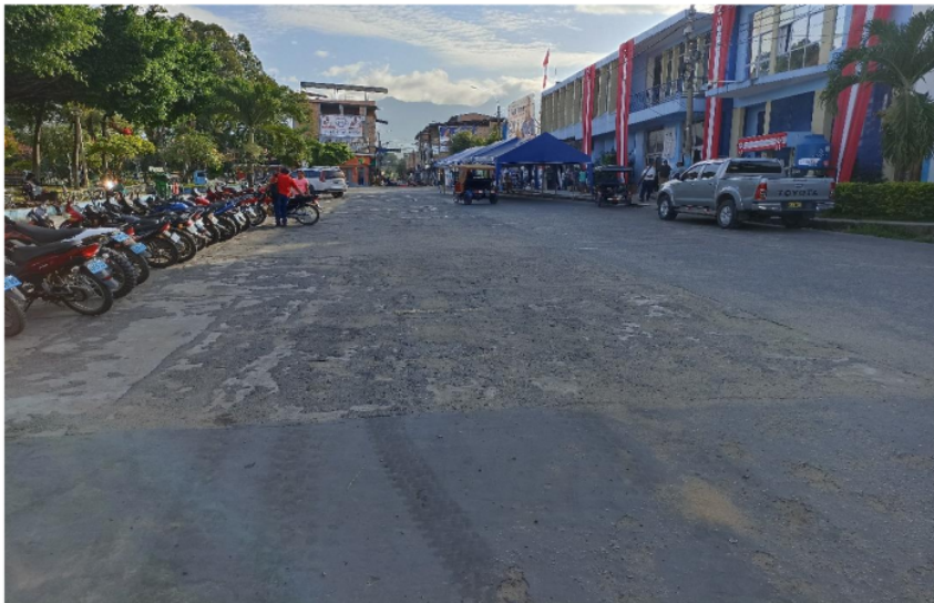
Fotografía 6: Se visualiza el deterioro del tratamiento superficial en el Jr. Tarapoto Cuadra – 1. Mismo que presenta desprendimiento y despostillamiento de juntas.
