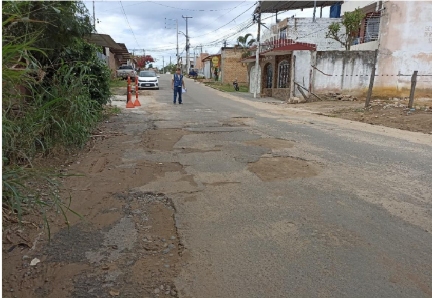
Fotografía 13: Se visualiza al testista un conjunto de deterioros/fallas de baches y reparaciones en el Jr. José Olaya Cuadra – 1
