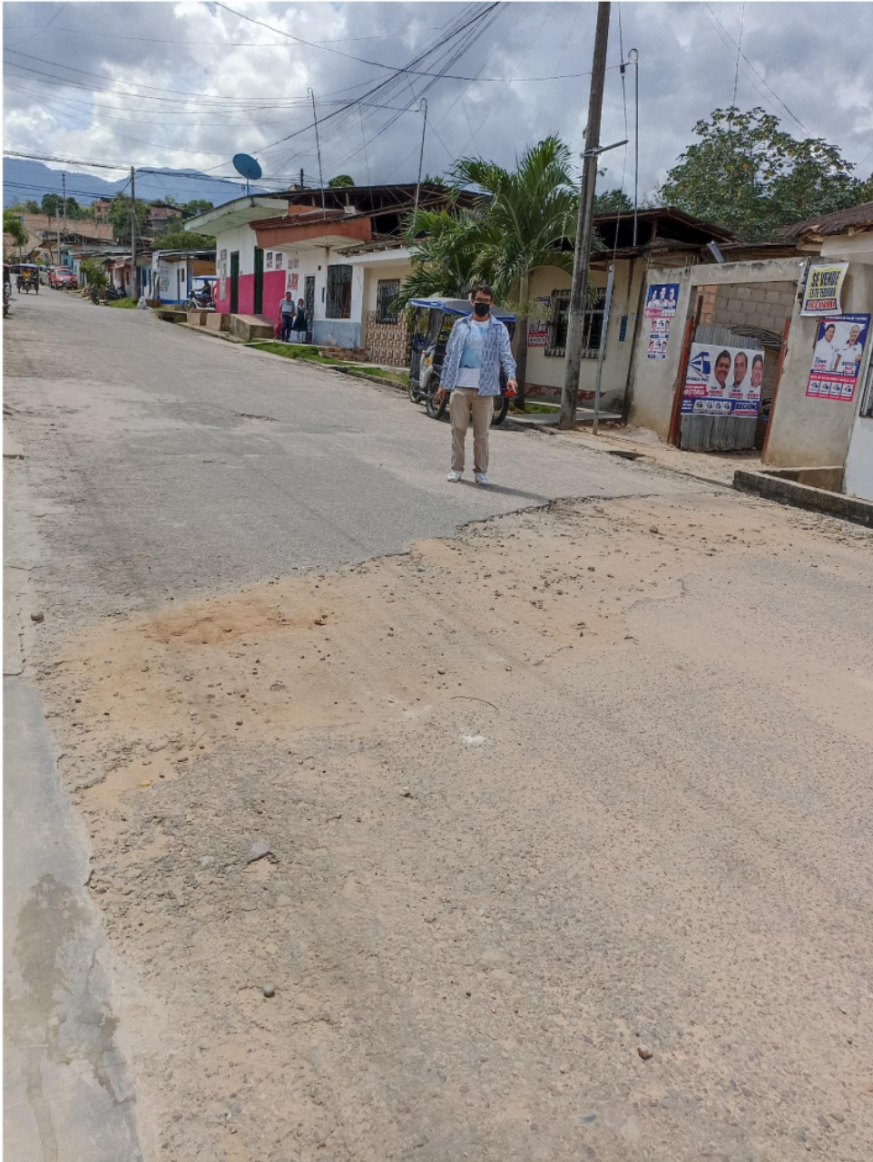
Fotografía 15: Se observa al tesista en el Jr. Bolívar Cuadra – 1, identificando una falla que posiblemente sea por la reparación o instalación del servicio de desagüe por parte de la EPS.
