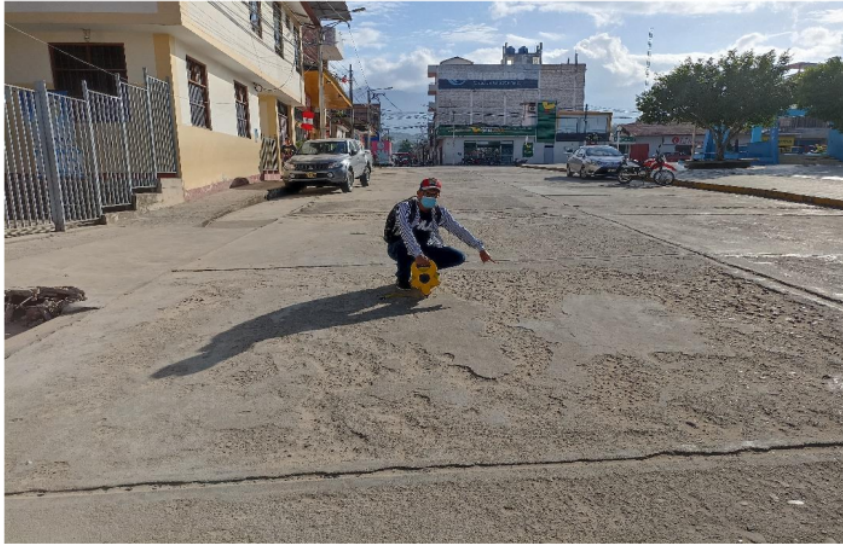
Fotografía 7: Se observa al tesista junto a los deterioros/fallas de desprendimiento y despostillamiento de juntas en el Jr. Augusto B. Leguía Cuadra – 1.
