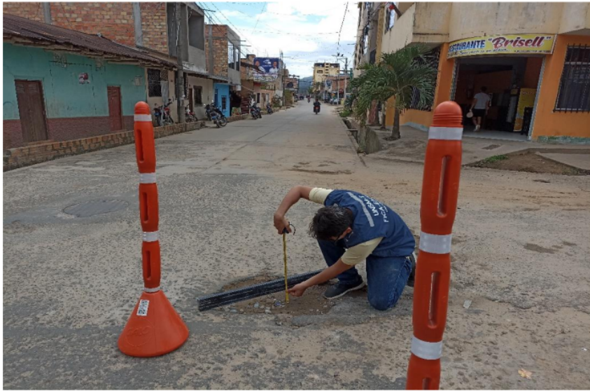
Fotografía 5: Se observa al tesista indicando el deterioro/falla de bache, de gravedad 3 en la intersección de los jirones Leticia y Sargento Lores, de profundidad 5cm
