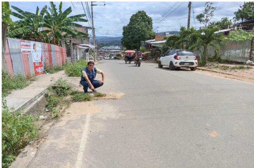
Fotografía 12: Se visualiza al tesista identificando una falla de bache que por falta de mantenimiento generó la presencia de vegetación, igualmente en el drenaje pluvial.
