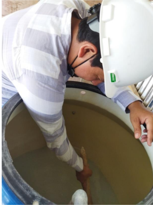
Fotografía 5. Dilución de cloro en tanque de cloración
