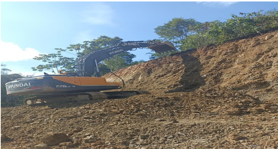
Foto N°6. Se observa a la excavadora Hyundai 220 Lc realizando el corte del talud en la progresiva 2+228.00.
