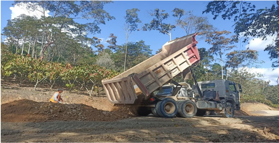
Foto N°5. Se observa al volquete dejando cada 15 metros el material que servirá para subbase de la carretera, corresponde a la progresiva 7+786.00
