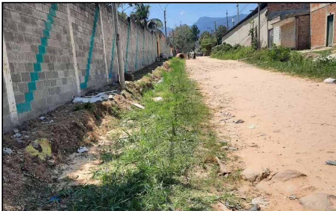
Figura 221. En la imagen se aprecia las cunetas construidos empíricamente por los pobladores ubicado al margen derecho de la cdra. 8 del jr. Circunvalación cumbaza (Fuente: Elaboración propia)
