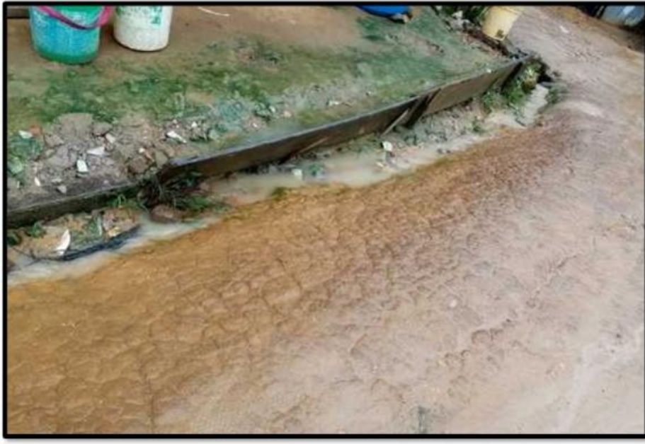
Foto 3: Un Mal sistema de drenaje pluvial es una fuente de contaminación y foco infeccioso.
