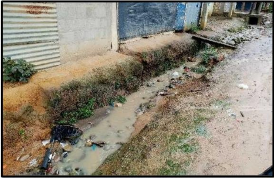
Foto 1: Se aprecia un ineficiente sistema de drenaje el cual afecta en la erosión de los terrenos y/o viviendas del caserío de aocaloma.
